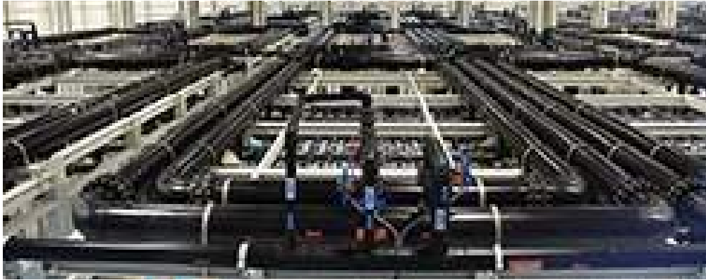
Азербайджан, Баку - Оборудование водоочистой станции (3700 электросварных седельных соединений и 19500 соединительных муфт) Azerbaijan - Bakü Infiltration - Water Treatment Plant 3,700 EF Saddles and 19,500 Fittings Connection
