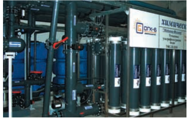
Установка ультраfiltrации из PVC-U на ОГК-6 (Новочеркасск)
